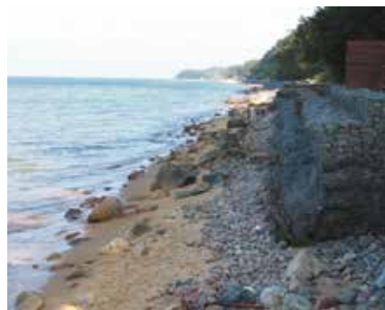
Рис. 1. Пример разрушения габионов
